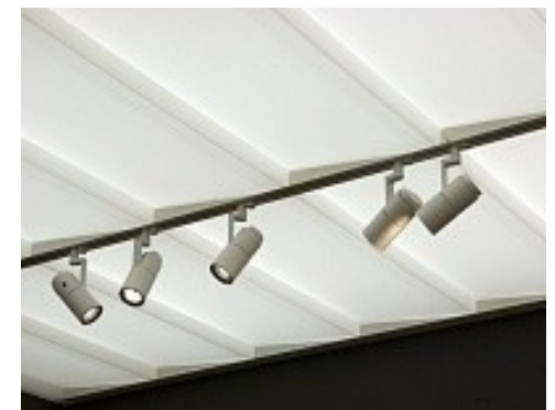
Imagen 63 Museo Rietberg, Zurich La flexibilidad y adaptabilidad de la iluminación artificial es clave para los diferentes montajes y exposiciones.
