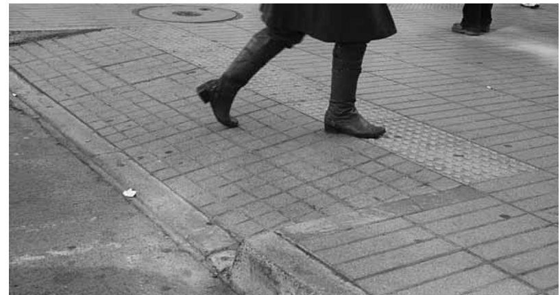
Imagen 50: rebaje correcto, se igualan los niveles entre vereda y calzada. El ancho corresponde a todo el cruce peatonal.
