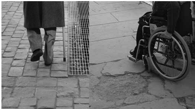
Imagen 46: material en mal estado dificulta circulación, superficie quebrada
