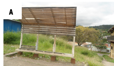
A vandalismo y deterioro desde su construcción en 2009
