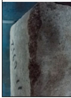
Pérdida de Aristas por desmoronamiento del material. Imagen 46
