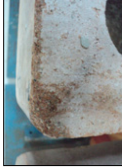
Esquinas quebradas por desmoronamiento de material. Imagen 47
