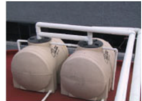
Imagen 45 : Tanque de almacenamiento en cubierta / Fuente : www.SENASA.go.cr
