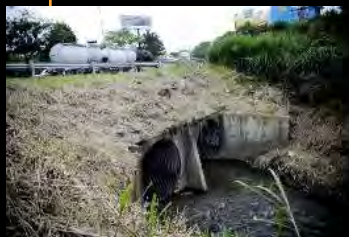
Titular: Otras seis alcantarillas ponen en riesgo la Circunvalación.
