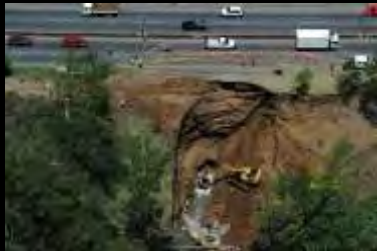
Titular: Hundimiento en la carretera de Circunvalación.
