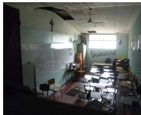
IMAGEN 1.24 (Deterioro de cielo falso)
