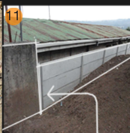
Muros de contención que han contruido para estabilizar sus terrenos y evitar el deslizamiento de terreno
