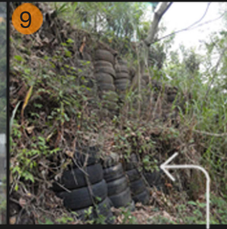
Vecinos han construido sistemas de contención del terreno alternativos, como lo es la utilización de llantas recicladas
