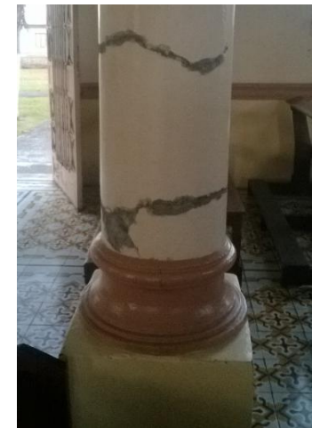
Imagen 3 : Daño Fachada Este y columna. Fuente propia. 02/2014
