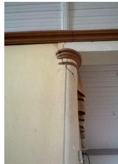
Imagen 6 : Daño estructural columna. Fuente propia 02/2014
