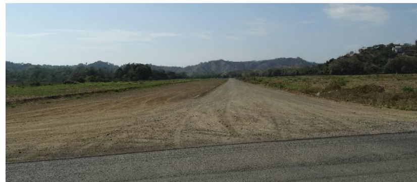
Imagen 7. Vista desde acceso al locus destinado para el Complejo Institucional. (2016) Elaboración propia
