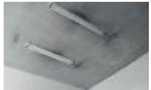
Imagen G29. Cielos suspendidos con marcas de humedad y quemaduras. Fotografía del autor.
