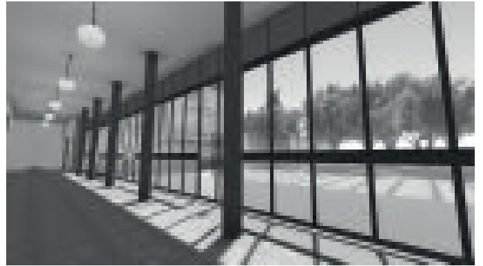
Imagen G82: Vista de los pasillos de primer nivel hacia la plaza, con los nuevos cerramientos en vidrio. Elaboración propia.
