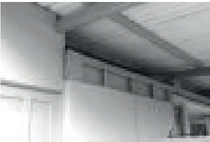
Imagen G34. Multiplicidad e incongruencia de sistemas constructivos. Fotografía del autor.
