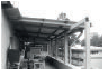
Imagen G35. Estructuras sin terminar con alto grado de corrosión. Fotografía del autor.
