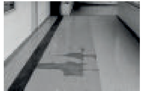
Imagen G36. Pisos cubiertos de vinilo que han dañado el piso original. Fotografía del autor.
