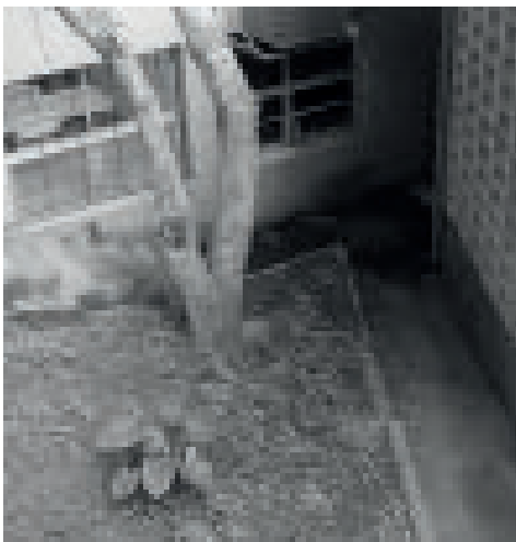
Imagen G42. Humedad y desechos orgánicos en la fachada este. Fotografía del autor.
