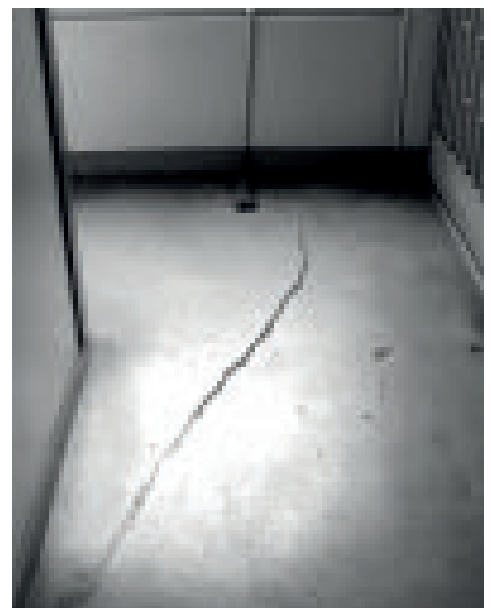
Imagen G30. Grietas en las losa del entepiso. Fotografía del autor.
