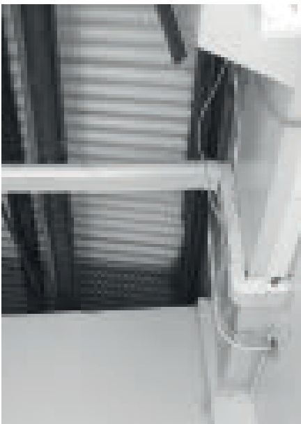
Imagen G37. Múltiples instalaciones eléctricas en mal estado. Fotografía del autor.
