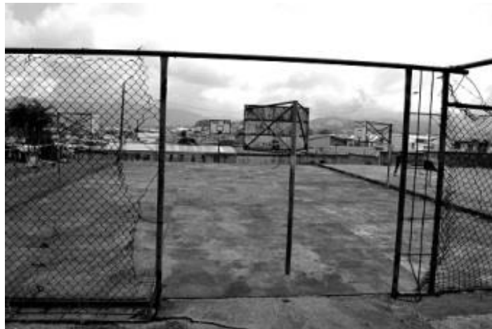
IMAGEN 2: POLIDEPORTIVO EN DETERIORO AVANZADO
