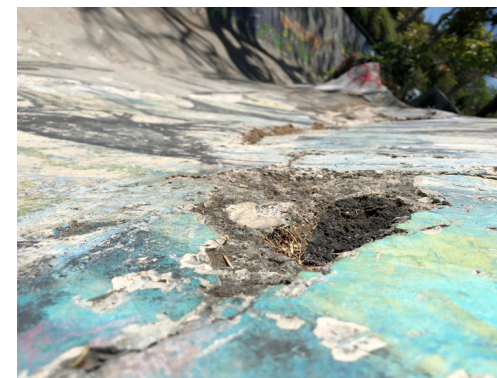
Imagen 63. Fotografía de grietas en rampas laterales del Caño (propia).
