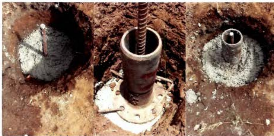
Vertido de concreto, colocación de brida e incrustación de varillas de soporte del monumento.
