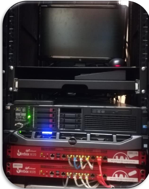
Fotografía 1. Servidor GIS en la Municipalidad de Alajuelita. Servidor HP ProLiant DL380 G6 Server, instalado en el rack y conectado a la red de la Municipalidad de Alajuelita. Fuente: Elaboración Propia.
