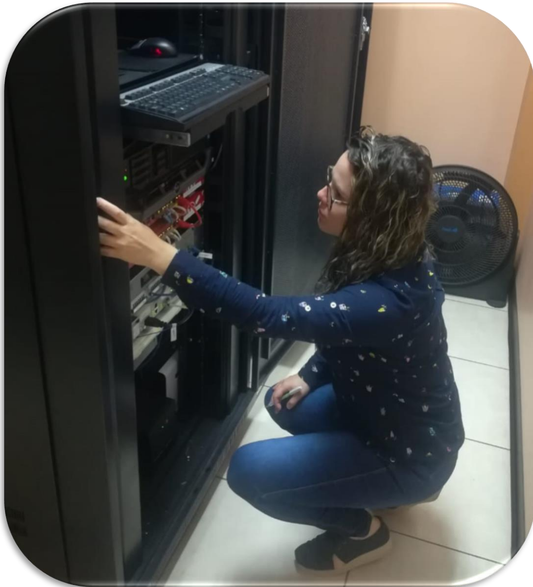
Fotografía 2. Servidor HP ProLiant DL380 G6 Server, instalado en el rack y conectado a la red de la Municipalidad de Alajuelita. Fuente: Elaboración Propia.
