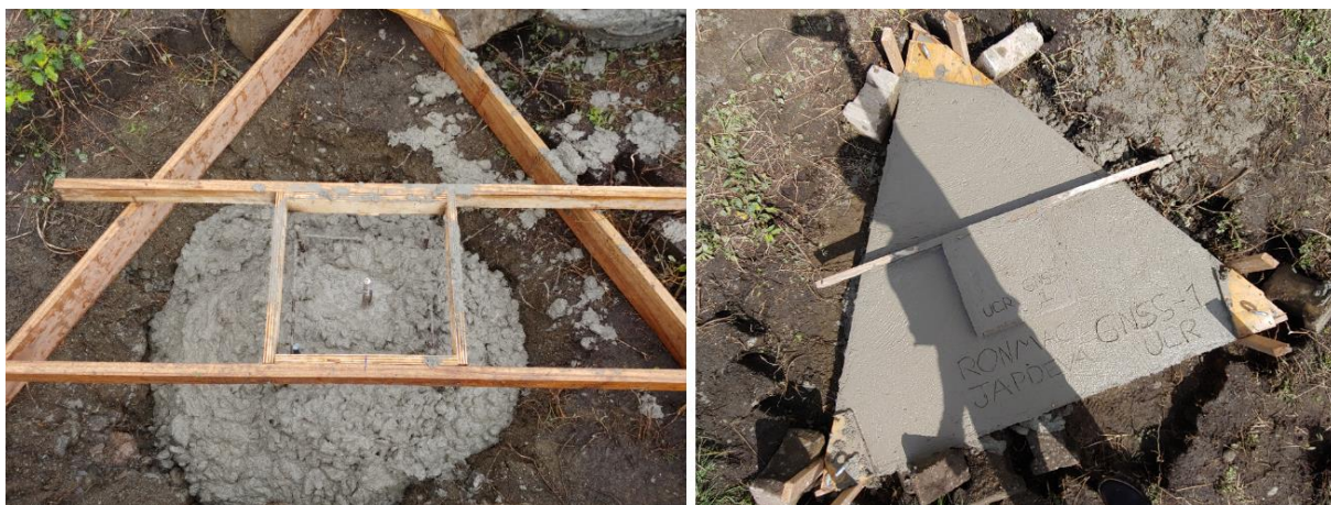
Figura 8. Colocación del mojón de concreto según las recomendaciones de la UNAVCO en el puerto de JAPDEVA. Fuente: Propia, 2021.
