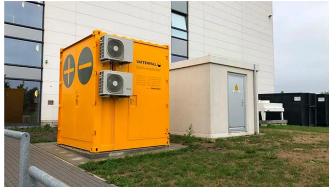
Figura 22. Sistema de respaldo con baterías.
