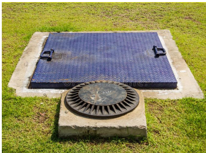
Figura 27. Registro de tanque subterráneo Fuente: Google, 2021
